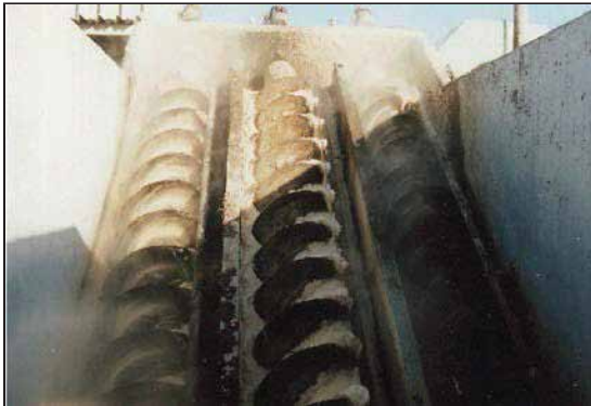
Tres bombas de efluentes en operación antes del recubrimiento
