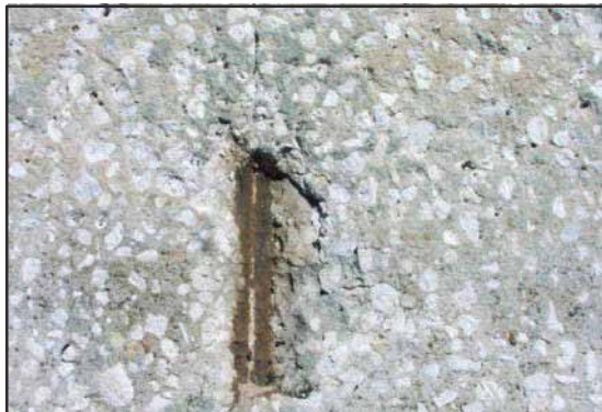
Concreto corroído con la barra de refuerzo expuesta.
