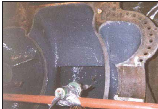
Bomba recubierta con ARC 855, ARC 858 y ARC 890.
