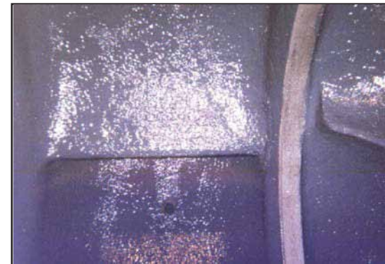
Corte de agua recuperado con ARC 890 y recubierto con ARC 855.
