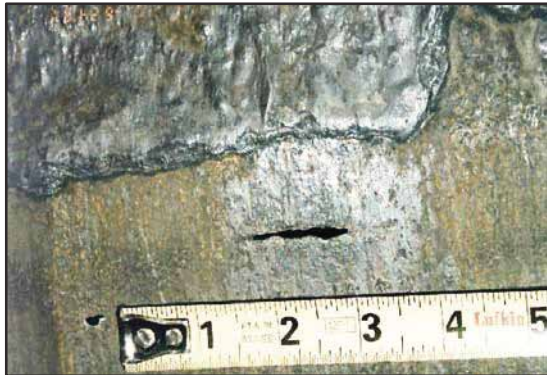
Abrasión y corrosión causaban daños pasantes en muchas áreas del silo.
