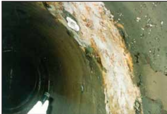
Corrosión significativa en las áreas donde falló el caucho.
