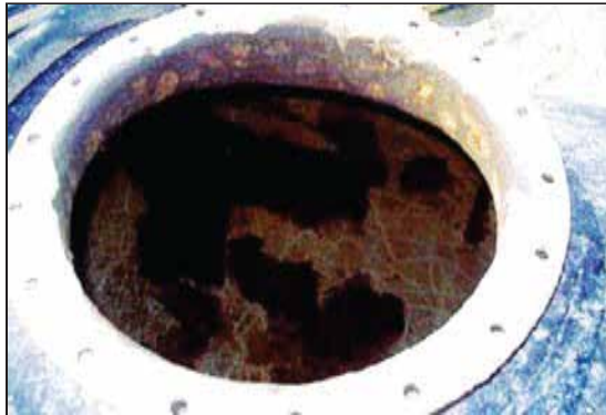
Falla del revestimiento fenólico.
