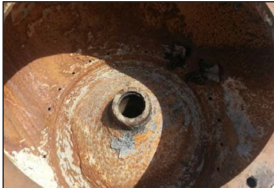
Bomba desgastada antes de 6 meses.
