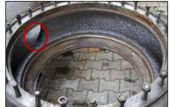
Carcasa después de 12 meses con ARC, muestra una pequeña área que requiere reparación.
