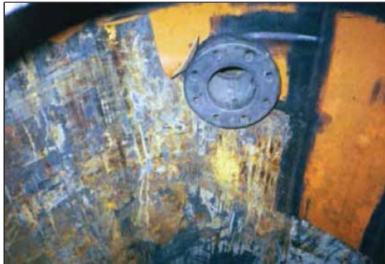
Remoción del recubrimiento de caucho en progreso. La formación de ampollas es visible.
