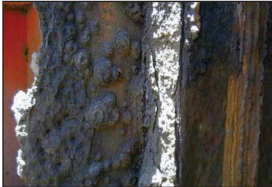
Pintura que falló después de un año de operación.
