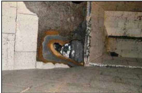
Falla de la línea de chutes después de 4 meses de haber reparado con parche de soldadura.
