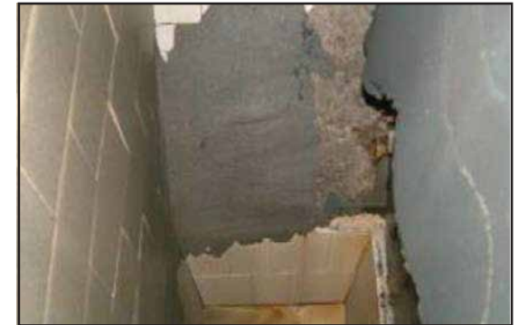
ARC MX5 después de 7 meses y permite reparación posterior.
