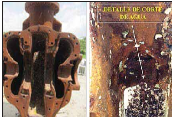
Inspección del cuerpo de la bomba.
