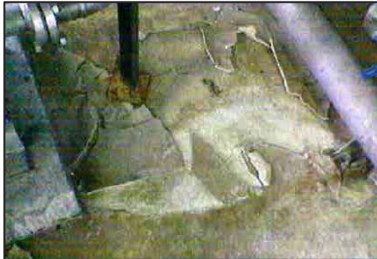
Revestimiento de poliéster reforzado con fibra de vidrio desprendido.
