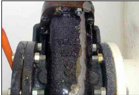
Fuga de la válvula controlada.
