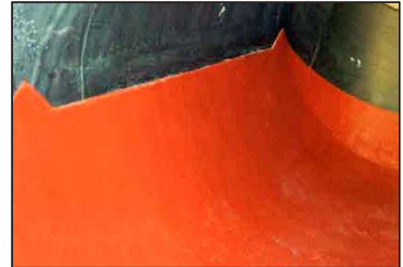
Unidad reparada lista para instalar.
