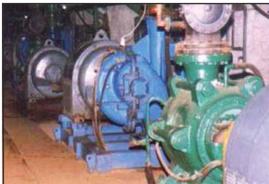
Banco de bombas de achique.
