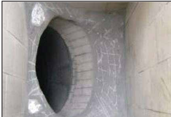
Daño de las losetas existentes causan paradas no programadas y pérdidas de producción.
