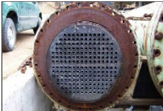
Placa tubular corroída.
