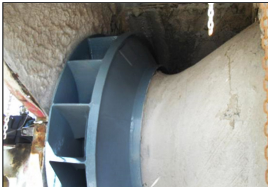
Ventilador instalado recubierto con ARC.
