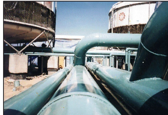
Tuberías de agua enfriamiento revestidas con ARC S2 .
