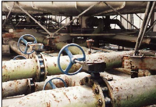
Tubería original pasados 6 meses.
