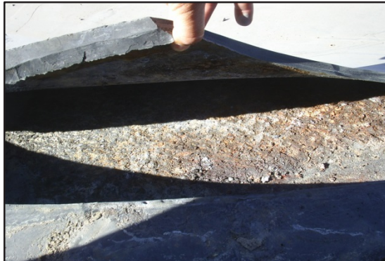
Desprendimiento y corrosión sub-laminar.
