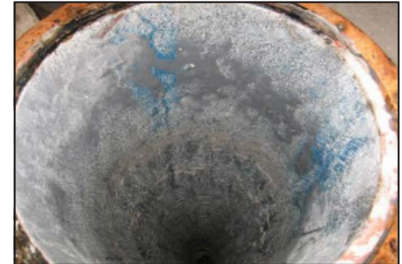
Inspección a los 12 meses, cono funciona perfecto.
