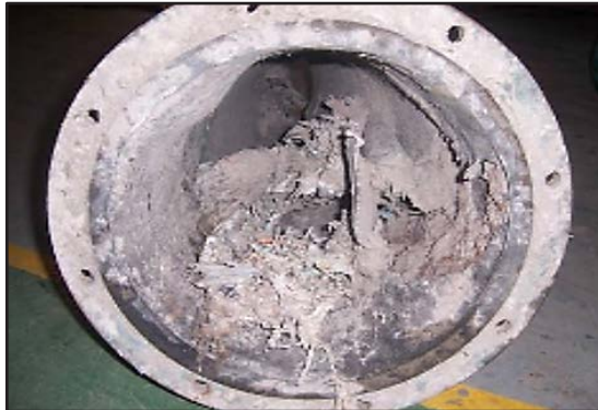
Revestimiento de caucho a los 3 meses.
