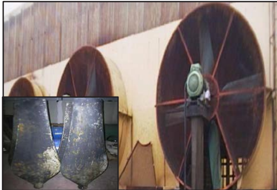
Aspas del ventilador dañadas.
