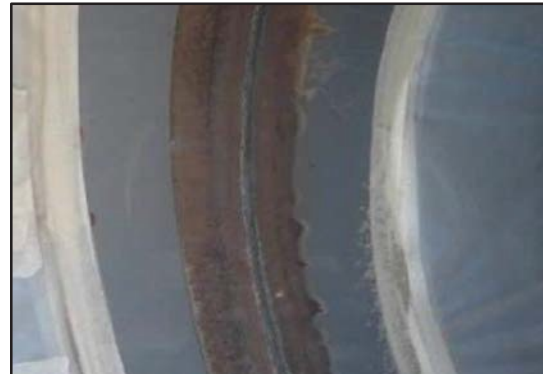
Aro de soldadura sin recubrimiento.
