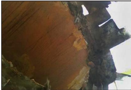
Tubería dañada por gases de escape corrosivos.
