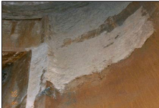
Corrosión severa dentro de la chimenea.
