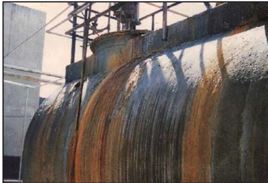
Tanques corroídos, contienen 98% H 2 SO 4 .
