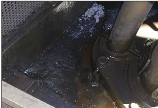
Estado inicial del concreto.
