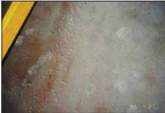
Corrosión y picadura sobre la compuerta de vertedor.
