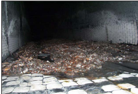
Salida de canal de descarga con losetas y revestimiento de caucho dañados.
