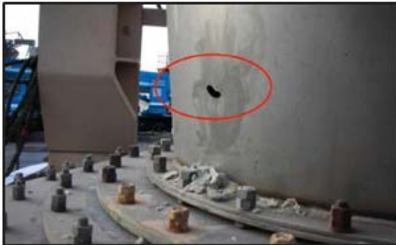
Escoria granulada crea agujeros en el chute de carga.
