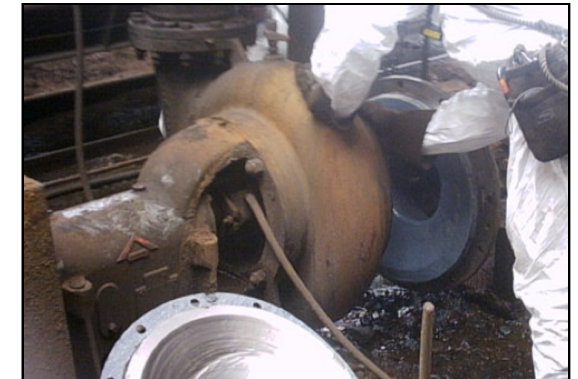
Instalación de la cubierta revestida con la cubierta dañada en primer plano.
