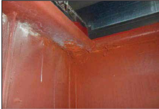
Recubrimiento original normalmente comienza a fallar dentro de los 12 meses de aplicación.
