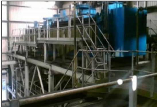
Celda de flotación.
