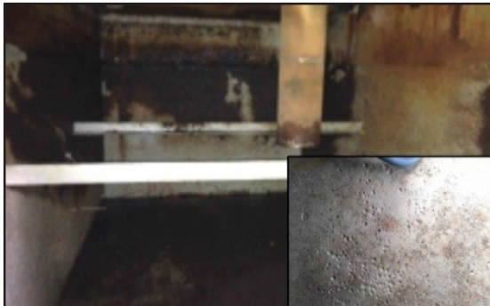
Corrosión severa en tanque de agua con glicol
